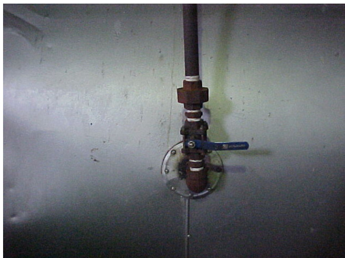
Figura 06 Registro de alimentação de vapor
