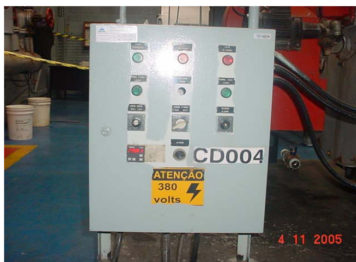
Figura 29 - Painel de comando
