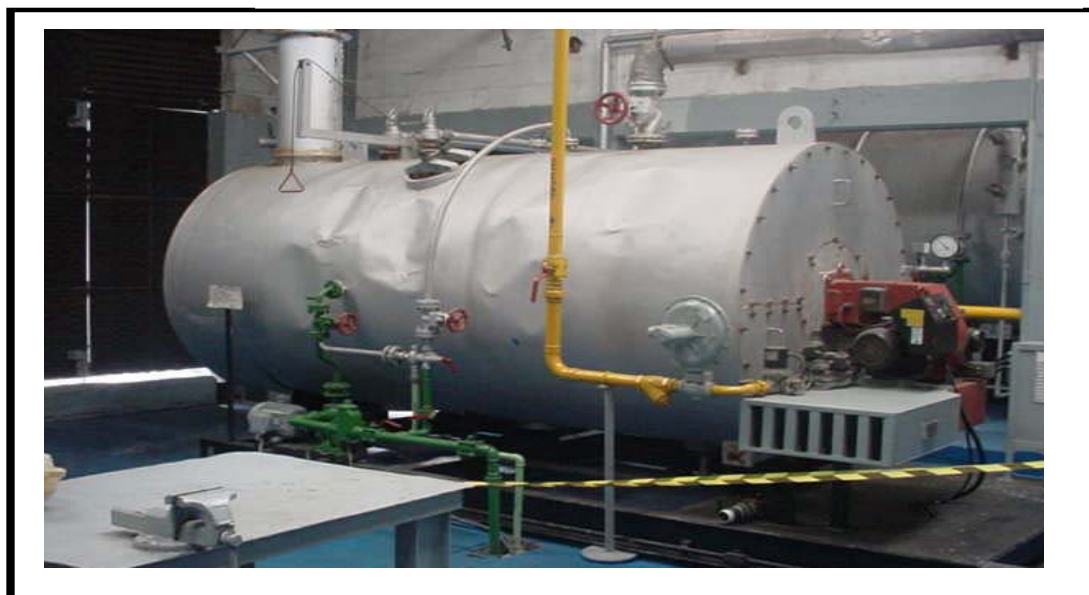
Fig 15 Caldeira com deformação da superfície.
