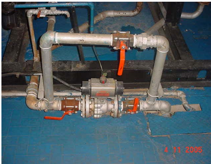
Figura 36 – Conjunto de válvulas de expurgo
