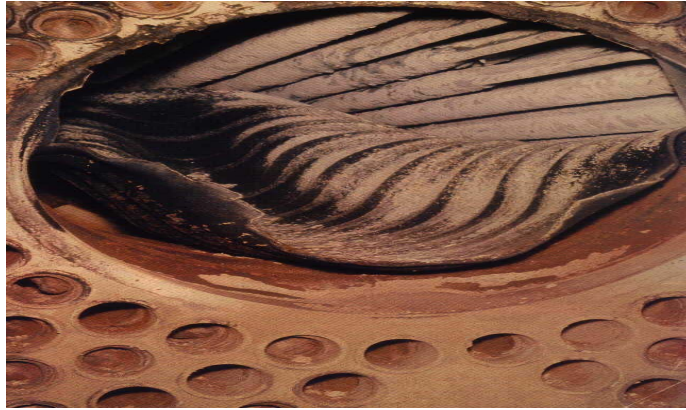
Fig. 22 – Estado de conservação: Manutenção zero
