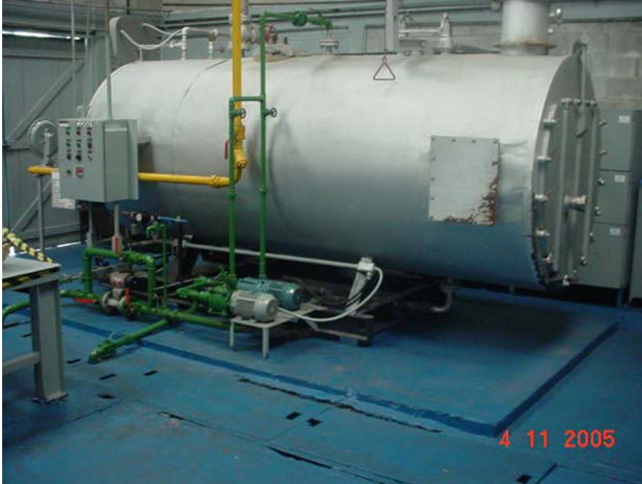
Fig. 01 Caldeira a vapor
