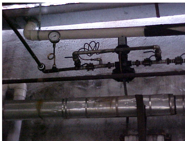
Figura 08 Manômetro e pressostato para controle de vapor na autoclave
