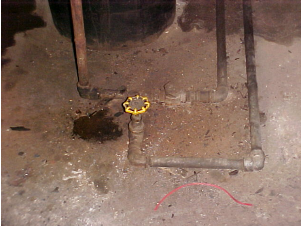
Figura 09 Válvula de expurgo
