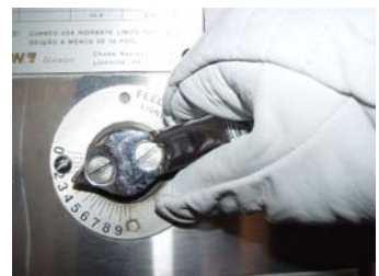
7- Consulte a tabela no painel da bomba e coloque a alavanca do dosador na posição desejada. Exemplo: para uma vazão de 200 GPM com espuma para 6%, colocar a alavanca na posição 3.5.
