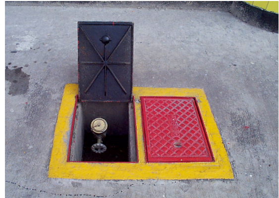
Figura 5.13 - recalque subterrâneo - no passeio
