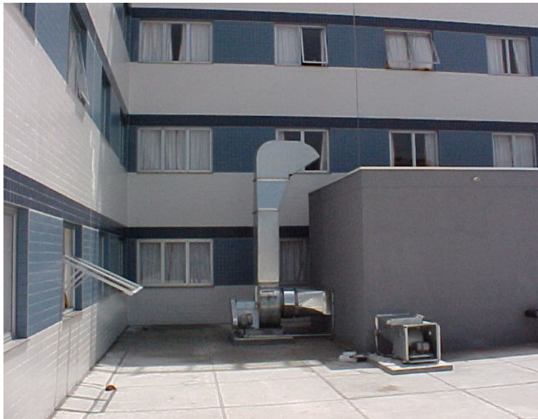
Figura 12.11 - ventiladores de extração mecânica de fumaça
