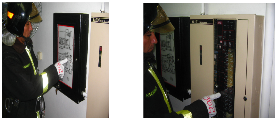
Figura 7.7 - Verificação da central de alarme e painel sinóptico
