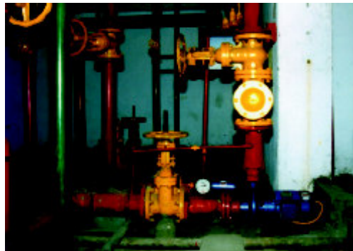
Figura 11.1 - Bomba de recalque
