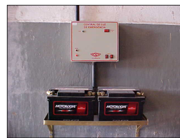
Fig. 8.3 - Central com bateria
