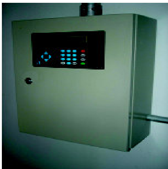
Figura 7.1 - Central de Alarme
