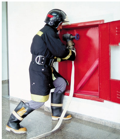
Figura 11.7 - Manobra do Bombeiro no hidrante
