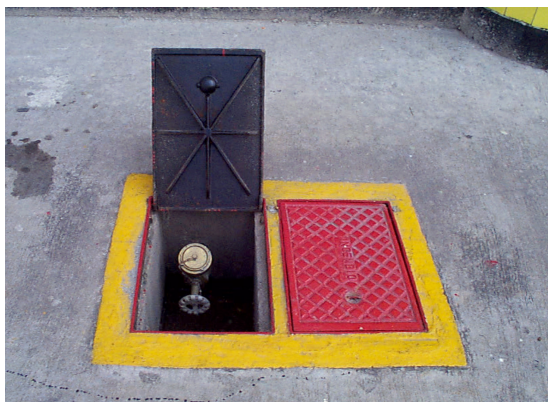
Figura 11.3 - Registro de recalque subterrâneo
