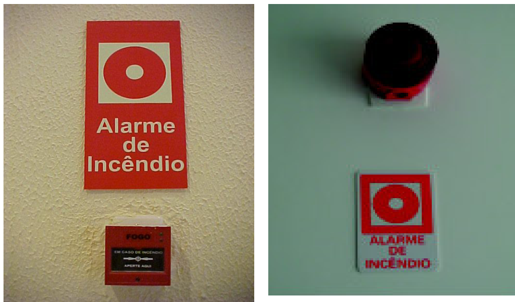
Figura 7.4 - Sinalização de alarme de incêndio
