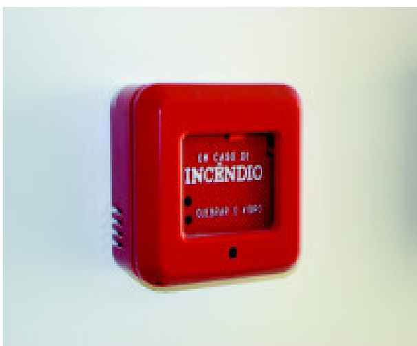
Figura 7.3 - Acionador manual do alarme de incêndio
