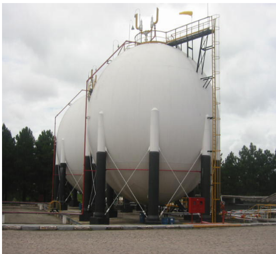
Figura 15.2 - Armazenamento de GLP em esferas
