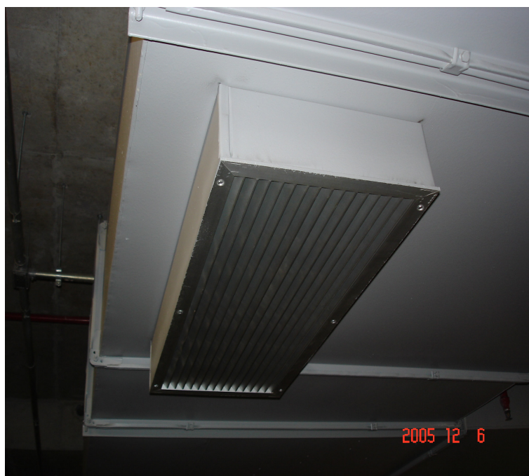
Figura 12.10 - grelha de extração de fumaça em dutos
