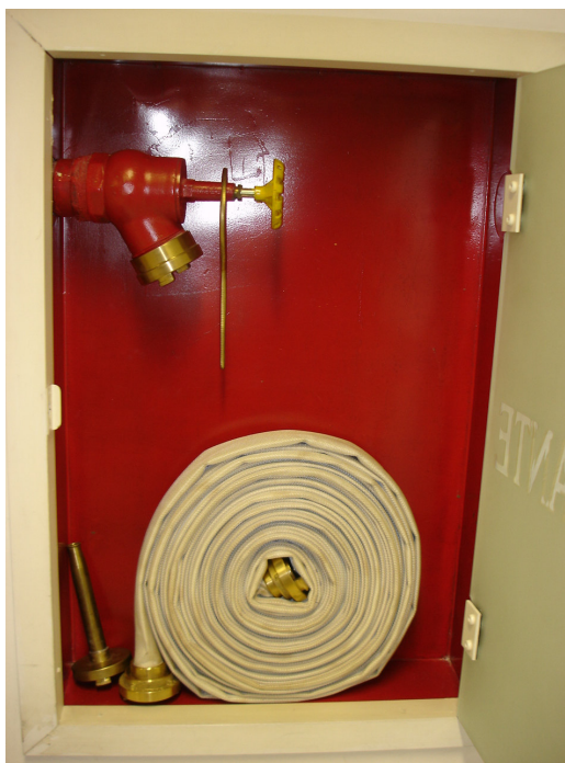
Figura 11.2 - Hidrante com mangueira, esguicho e chave de mangueira
