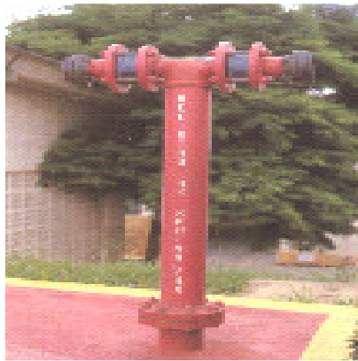
Figura 5.12 - recalque tipo coluna
