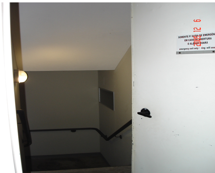
Figura 12.9 - Exemplo de escada pressurizada
