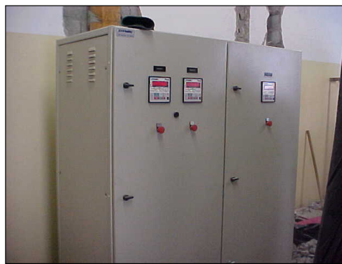
Figura 8.8 - Painéis de controle
