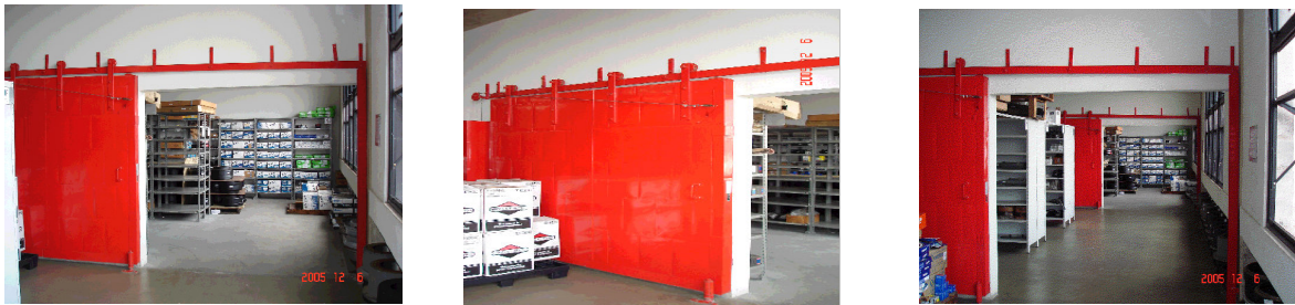
Figura 3.3 - Exemplos de compartimentação de áreas através de portas corta-fogo de correr
