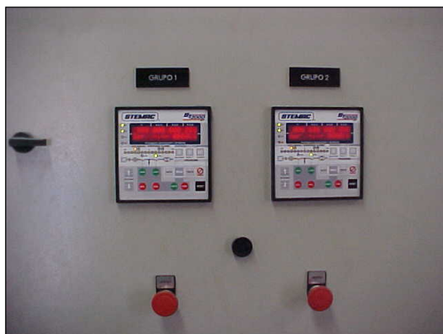
Figura 8.7 - Painéis de controle
