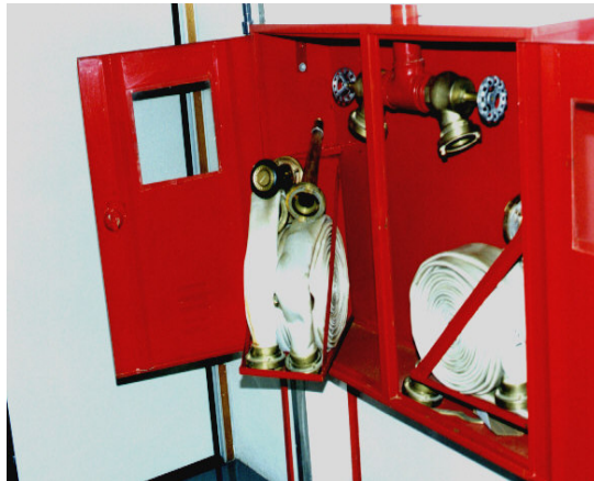
Figura 11.4 - Localização de hidrante
